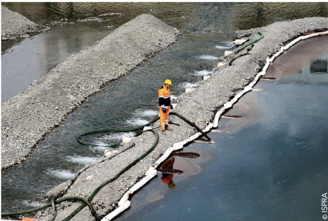
Image : Remblai et tuyaux inclinés afin de filtrer la matière polluante flottante
